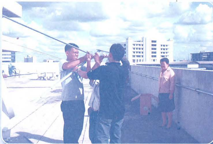
การติดตั้งระบบสื่อสารดาวเทียม สำหรับศูนย์ข้อมูลเฝ้าตรวจการ ทดลองอาวุธนิวเคลียร์
