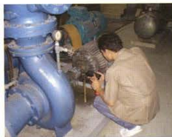
การตรวจสอบระบบระบายความร้อน
