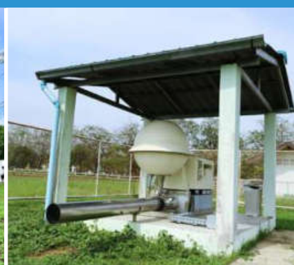
ระบบการเก็บตัวอย่าง และระบบตรวจวัดอุณหภูมิ และความชื้นภายนอกอาคาร
