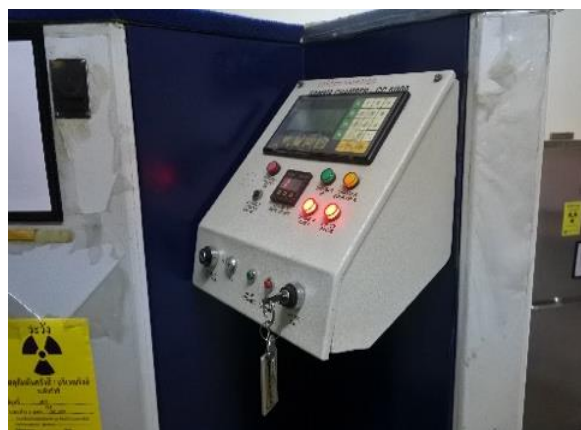
รูปที่ 6 อุปกรณ์ระงับเหตุฉุกเฉินทางรังสี
