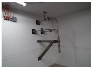
รูปที่ 13 ท่อนำส่งวัสดุกัมมันตรังสี
