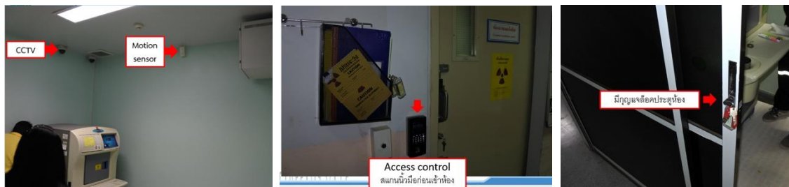
รูปที่ 1 แสดงตัวอย่างอุปกรณ์ควบคุมการเข้าออกเฉพาะบุคคล (Access control) , CCTV และ Motion Sensor
