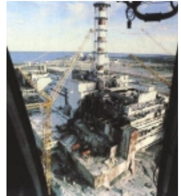
รูปแสดงโรงไฟฟ้าเชอร์โนบีลที่ได้รับ ความเสียหาย
