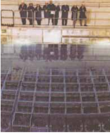
บ่อเก็บเชื้อเพลิงใช้แล้วภายใน โรงไฟฟ้านิวเคลียร์
