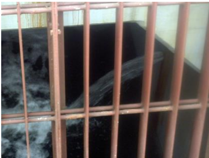
รูปที่ 4 แสดงภาพน้ำบาดาลไหลเข้าสู่อาคารอย่างต่อเนื่อง 4
