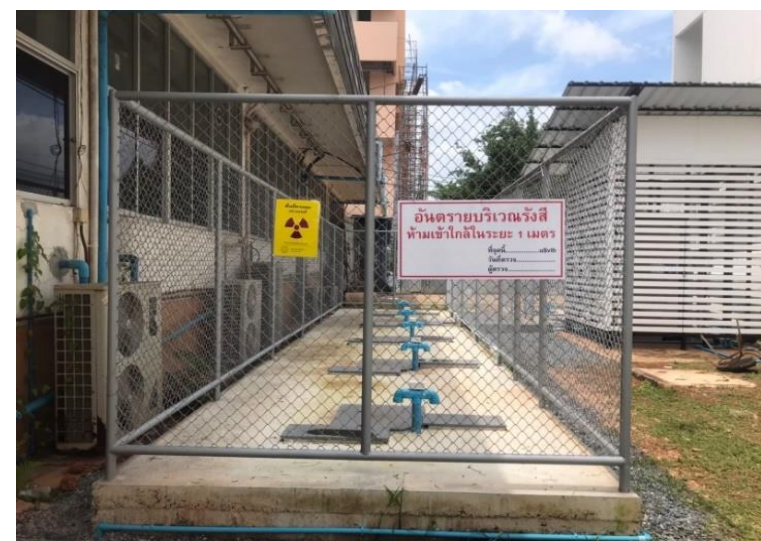
รูปที่ 3 บ่อพักน้ำทิ้งเพื่อรอการสลายตัวของไอโอดีน-131
