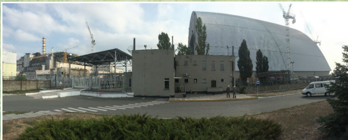
อุปกรณ์คลุมเครื่องปฏิกรณ์ (ด้านขวา) อยู่ในระหว่างก่อสร้างซึ่งคาดว่าจะแล้วเสร็จในปี พ.ศ. 2560 และจะคลุมโครงสร้างของอาคารเครื่องปฏิกรณ์ปรมาณูหน่วยที่ 4 ทั้งหมด (ด้านซ้าย)
